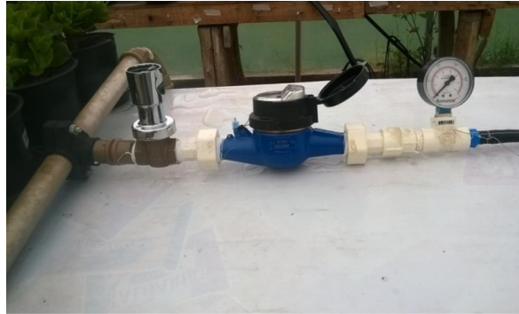
Figura 2. Bancada experimental com registro gaveta, hidrômetro, conjunto tê com manômetros e conectores.
